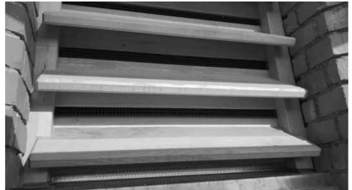
Neuer Schallladen mit Ableitung des Regenwassers
